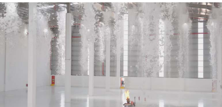
* 高性能な高膨張消火泡システム
